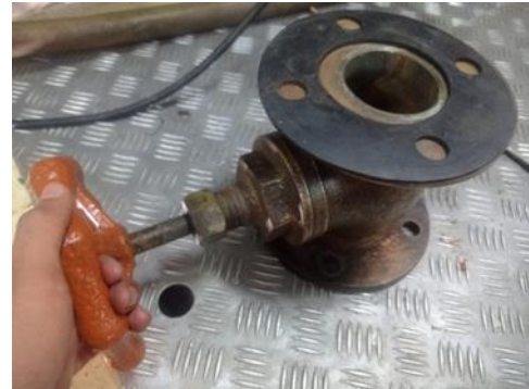
Gambar 15. Keran penghubung filter dan pipa
